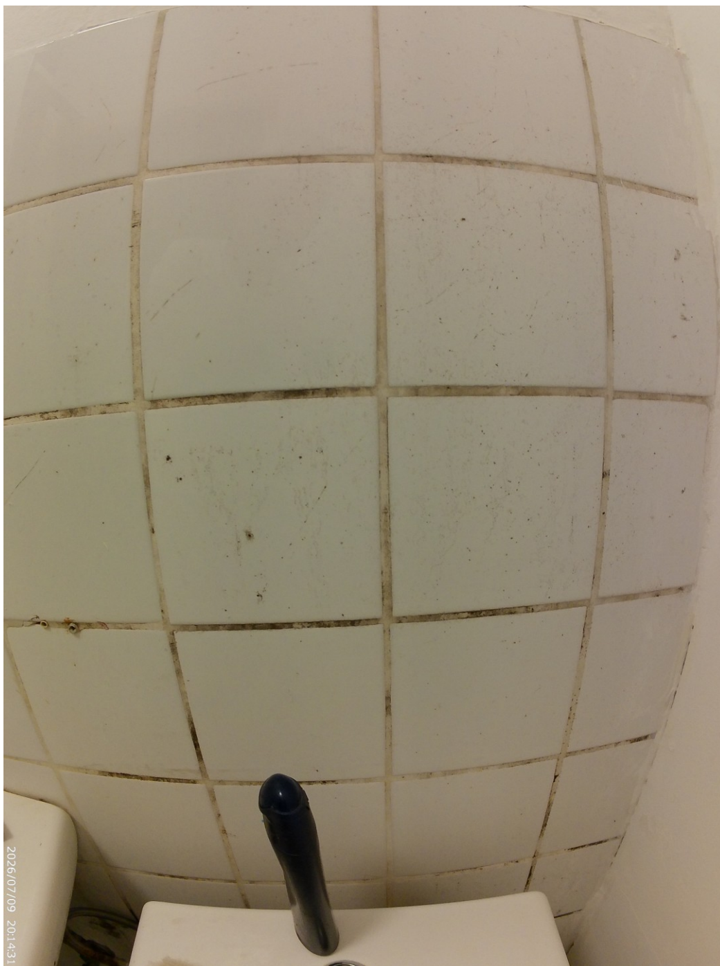
Moisissures depuis la réception des clés, état originel !
