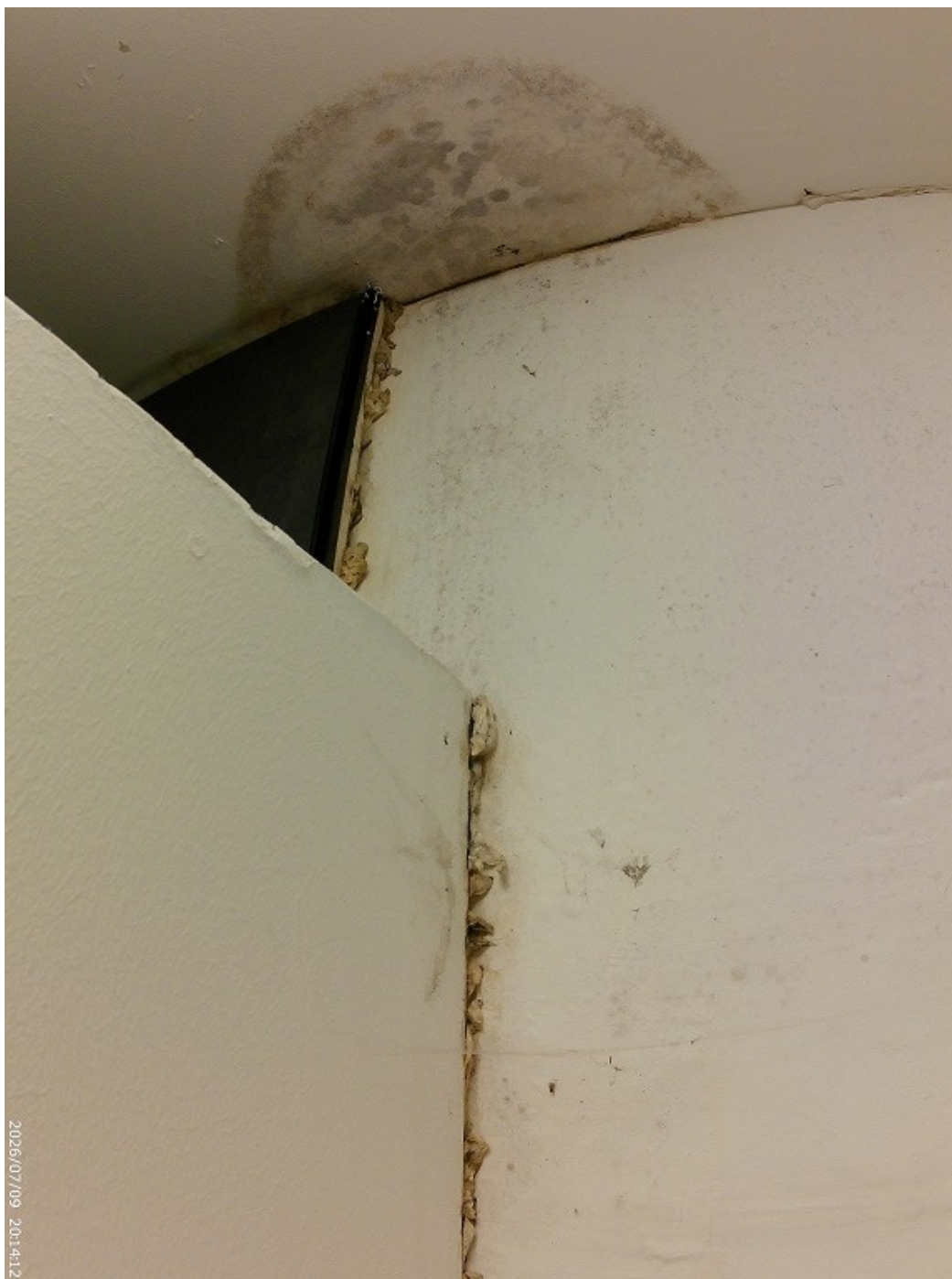
SDB du rdc suite aux écoulements venant du 1 er .
